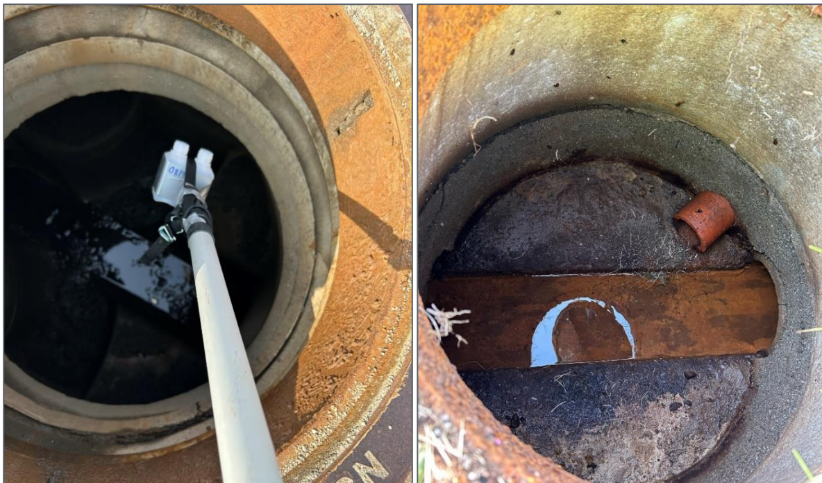
Figur 3-1: T. v.: eksempelbilde av prøvetaking av kum (kum 0817). T. h.: eksempelbilde av tørt drensrør, men vann i kum (kum 2455).
