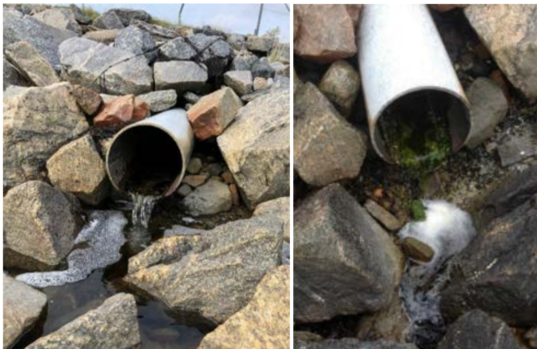
Figur 5-4: Vannmengder i utløpspunktet for overvannssystemet (P3) på østsiden av rullebanen ved prøvetakingen i september 2020 (venstre) og april 2021 (høyre). Bildet til venstre er tatt på flo.
