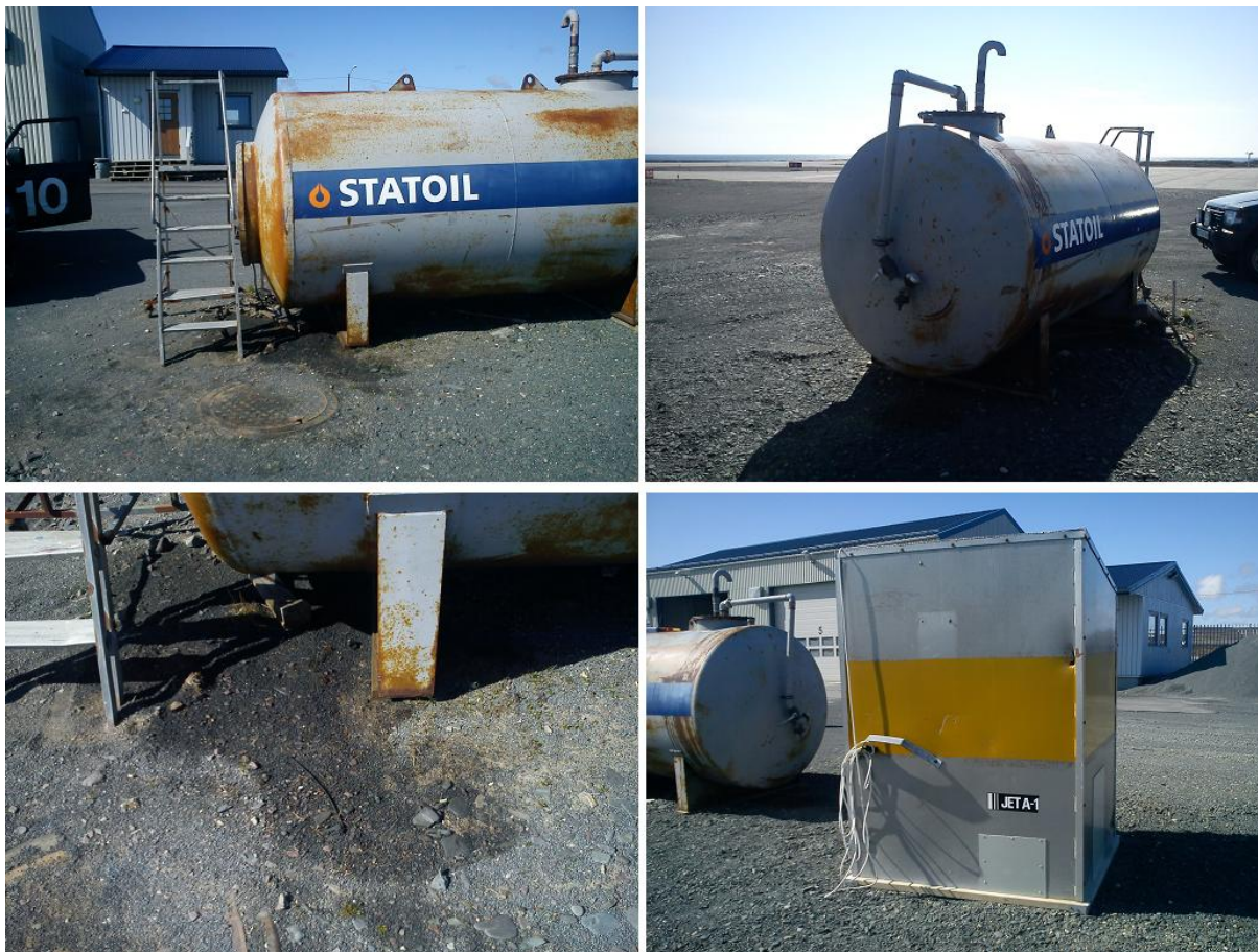
Figur 3: Bildet viser diesel tank for kjøretøy og den tidligere Jet-A1 fueling-skap.
