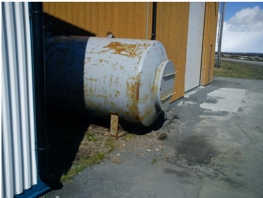
Figur 4: Bildet viser dieseltank for kjøretøy.
