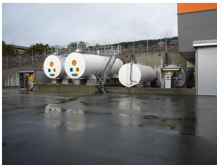
Figur 1: Nåværende drivstoffanlegg Jet-A1 (venstre side) og dieseltank (høyre side).
