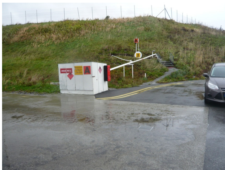
Figur 2: Nåværende avgass-100-LL-drivstoffanlegg med miljøbrønn MB1. Miljøbrønn MB2 ligger til høyre for avgassanlegget.
