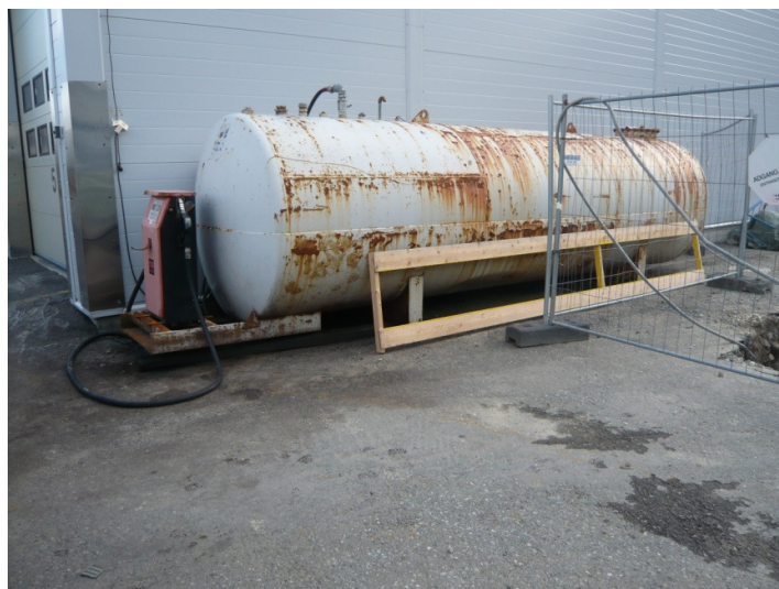
Figur 3: Dieseltank ved siden av verkstedsbygg.
