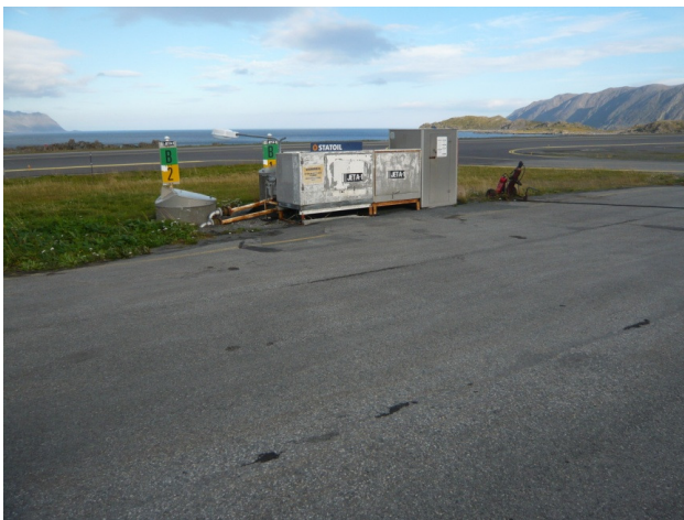
Figur 2: Gammelt drivstoffanlegg Jet-A1 mellom taksbanene.
