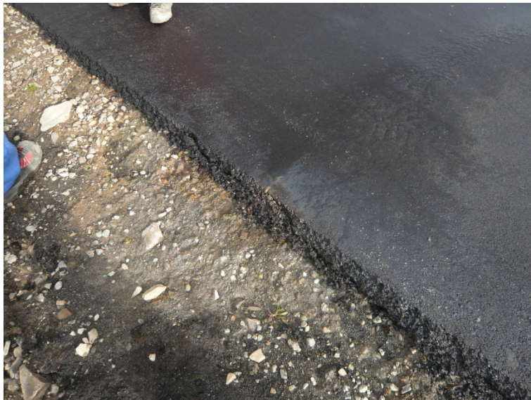
Figur 2: Oljesøl på asfaltkanten ved nytt Jet-A1-tankanlegget.
