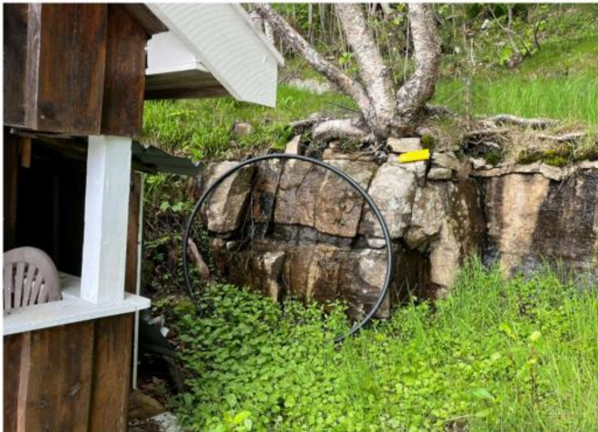
Figur 6: Vann renner ned over bergflaten og via vannførende sprekker i fjellet. Bildet er fra befaring i boligfeltet i mai 2025.
