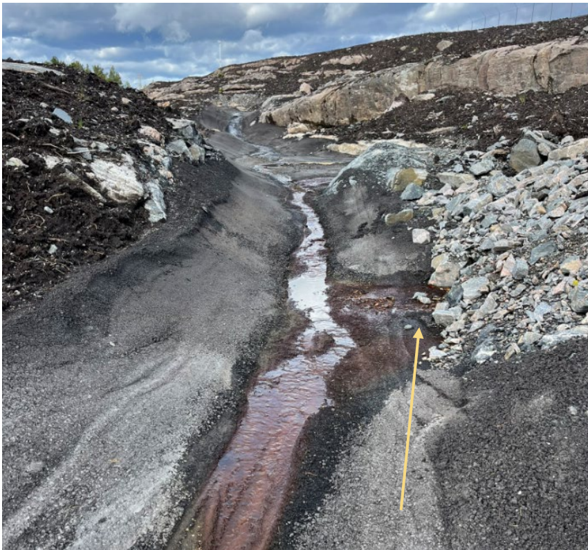
Figur 9: Avskjærende grøft sett mot nordvest. Gul pil: vannsig fra oversiden av grøften. Bilde: COWI, 28.05.25.
