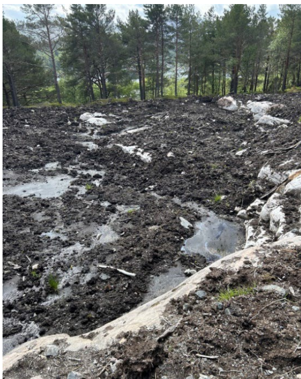
Figur 7: Vannsump som ikke fanges opp av grøfter (Pkt. 19, Figur 2). Bilde: COWI 28.05.2025.
