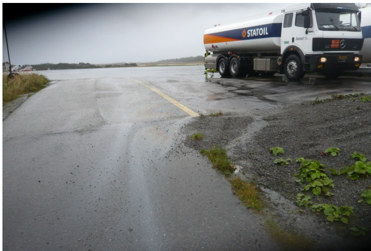
Figur 3: Oljefilm på asfalterte veien ved Jet-A1-tankanlegget.
