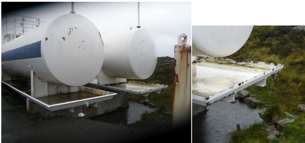
Figur 2: Jet-A1-dagtankene med oppsamlingskar med åpen avløpstappekran (høyre tank).
