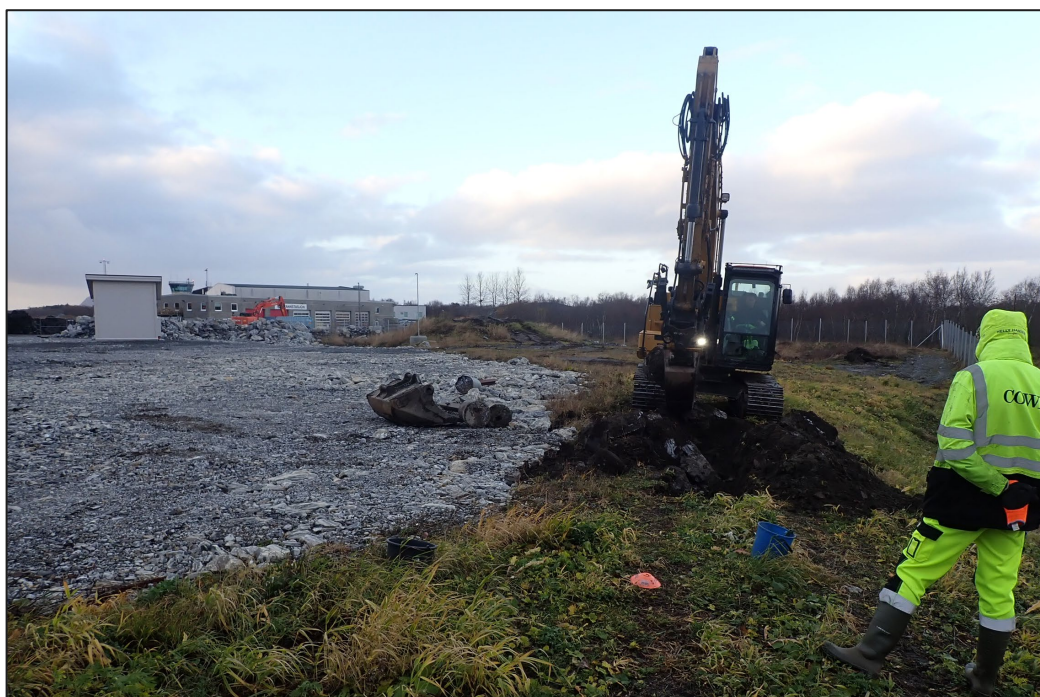
Figur 34 Foto fra prøvegraving av sjakt SJ5 som viser at deler av BRAL var masseutskiftet med grove masser av stein/pukk.
