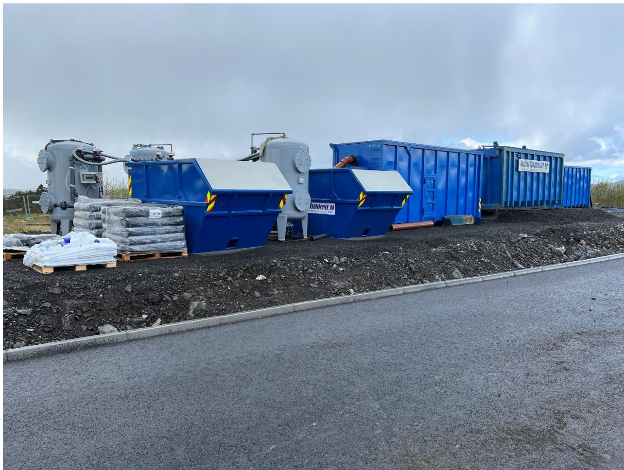
Figur 6-1: Midlertidig vannrenseanlegg for rensing av oppsamlet avrenningsvann.
