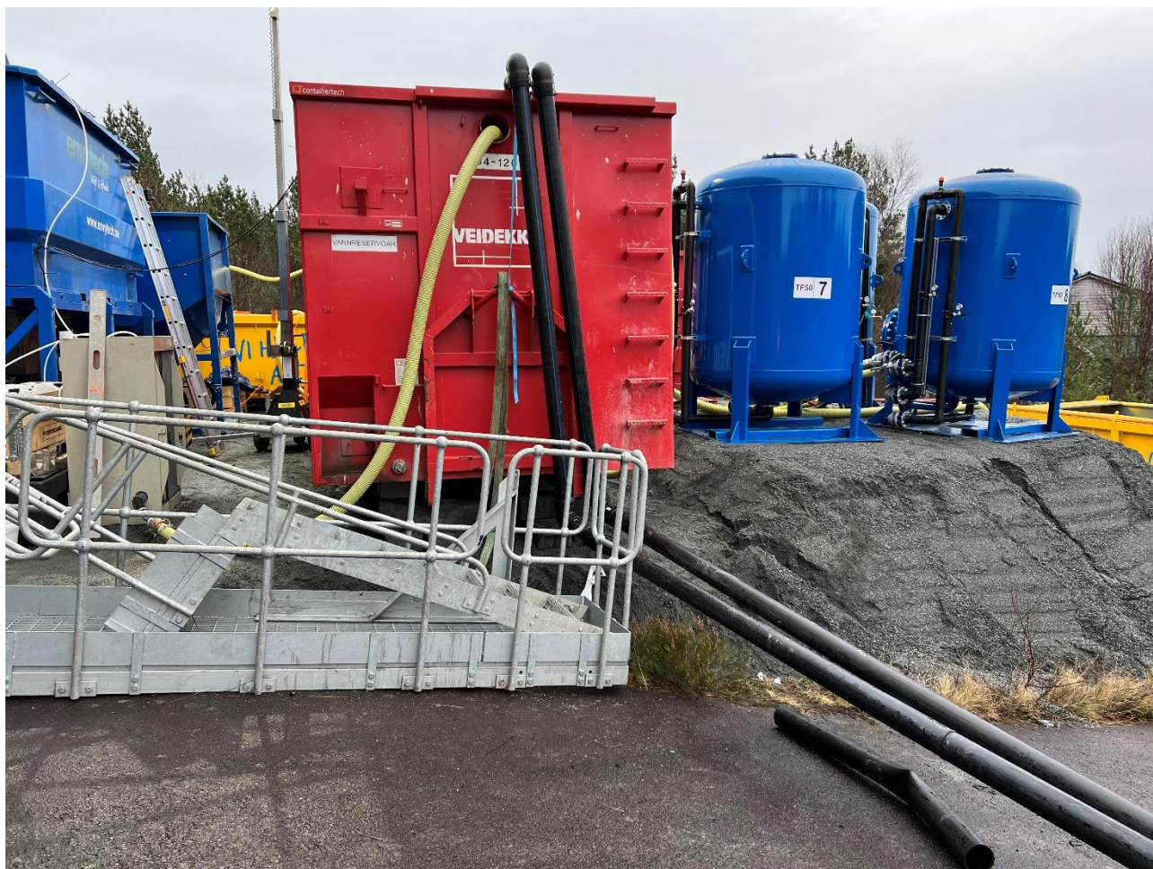
Figur 6-1: Midlertidig vannrenseanlegg for rensing av oppsamlet avrenningsvann fra delområde 1a og 2.
