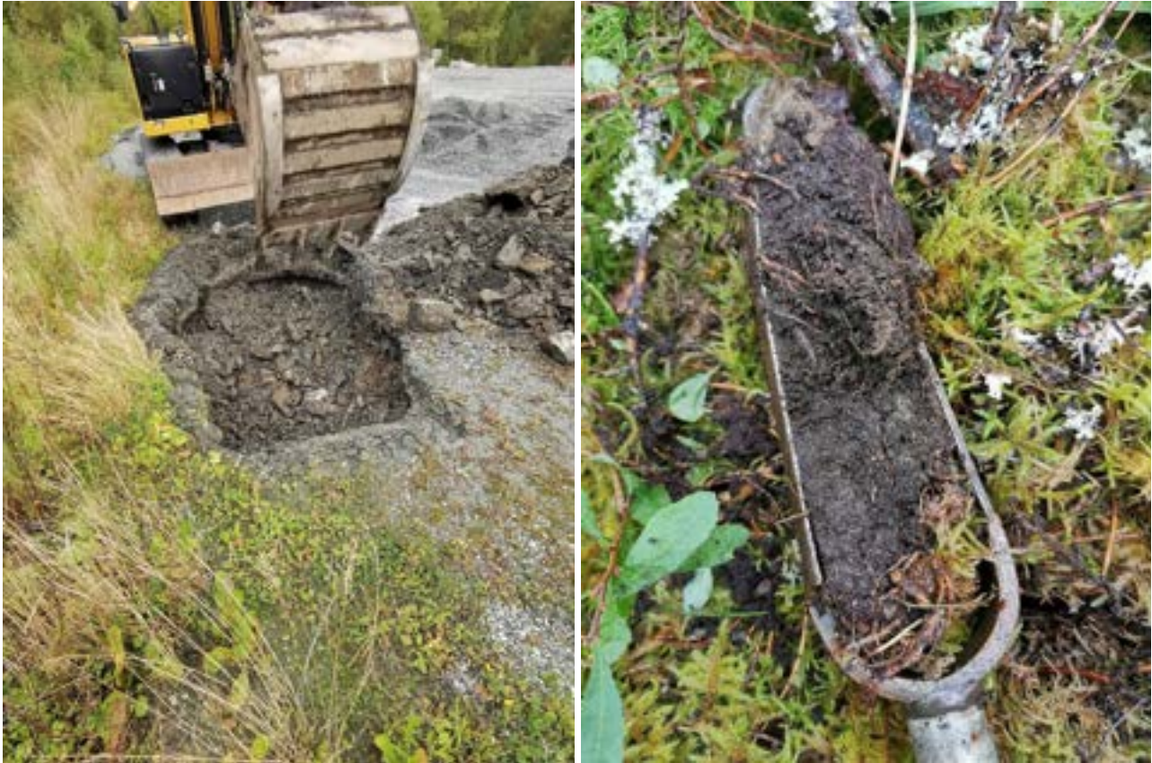
Figur 3-2: Massene sentralt på nylig nedlagt brannøvingsfelt (BØF1) er generelt karakterisert av grove fyllmasser i varierende mektighet (1,1 – >1,7 m) over fjell (venstre bilde). I skogsområde nord for feltet er massene karakterisert av tynt skogsjorddekke (0,2-0,4 m mektighet) over fjell (høyre bilde).
