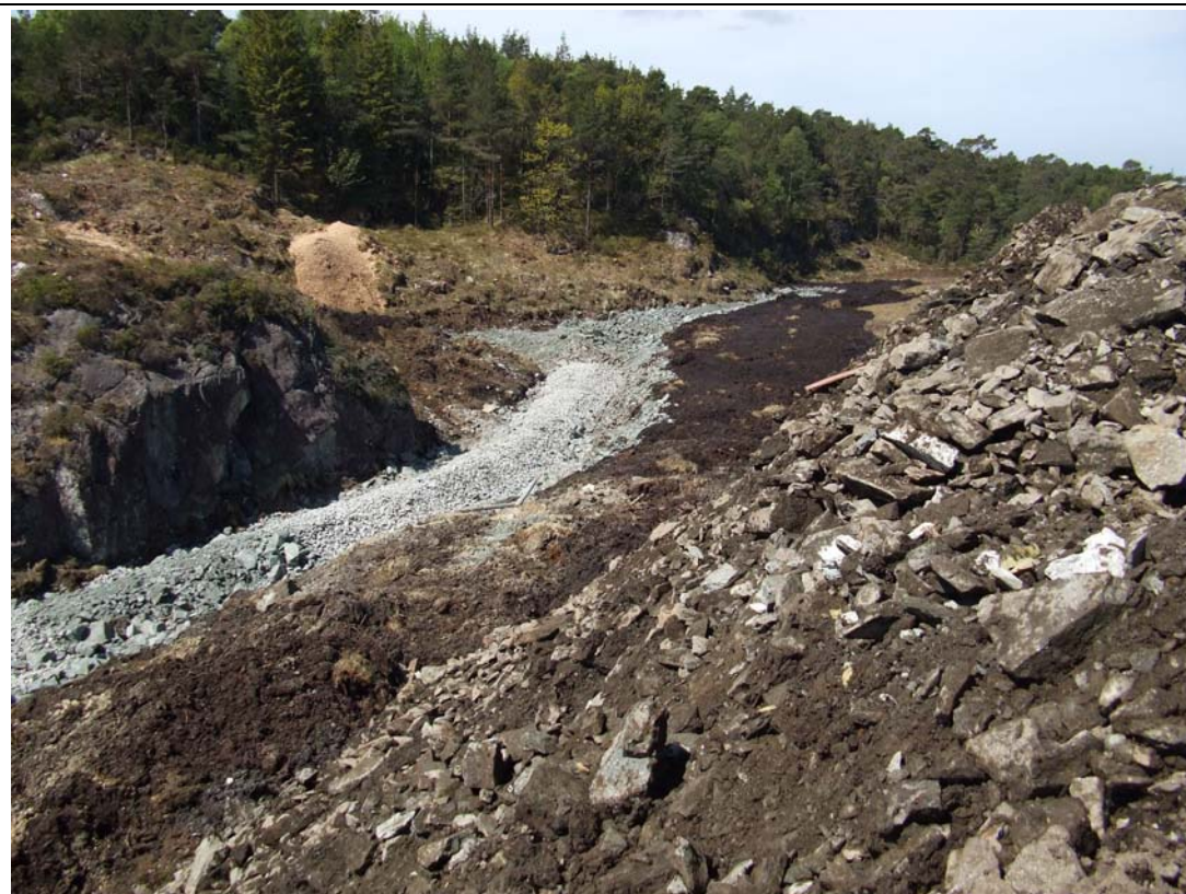
Figur E-1. Etablering av avrenningsgrøfter i deponi Nord. Bildene er tatt mot nord, av utførende entreprenør. Grøfta som går midt i bildet er avrenningsgrøft lengst i vest. Bløtdeponiet ligger i enden av denne grøfta (se nedre bilde). Dammen i det øverste bildet er sedimentasjonsdammen.
