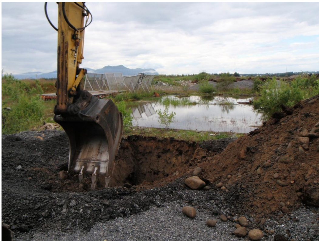
Figur 7. Gammelt Brannøvingsfelt med betongkar. Graving ved sjakt 28.
