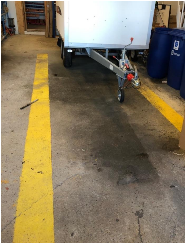
Figur 4: Synlig oljesøl på betonggulvet i verkstedhallen.
