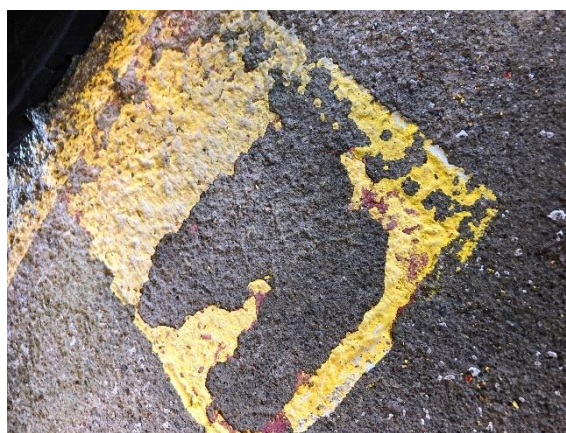
Figur 3: Gul- og rødmaling til ledelinjer på betonggulvet i driftsbygningen, bilde er fra hallen for oppstilling av utrykningskjøretøy. Malingen er forurensset med sink og PCB.
