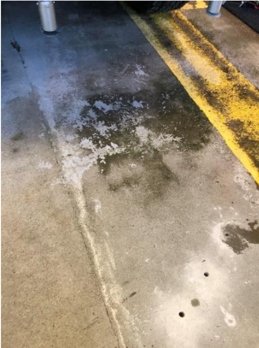
Figur 6: Betonggulv i hall for utrykningskjøretøy, prøve ENSH-MKDRI-P3, forurensset med krom (VI) og PFAS.
