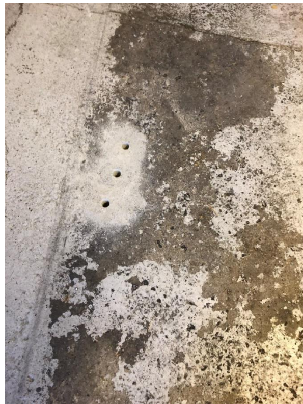
Figur 5: Prøve ENSH-MKDRI-P2 i verkstedhallen. Betongen er forurensset med olje, krom VI og PCB.
