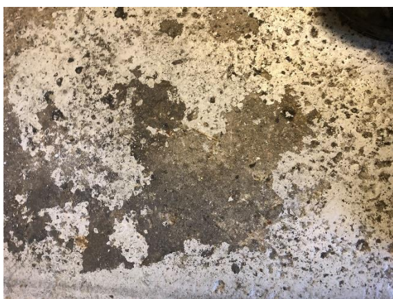
Figur 2: Gråmaling på betonggulvet i deler av verkstedhallen. Malingen er forurensset med sink og PCB.
